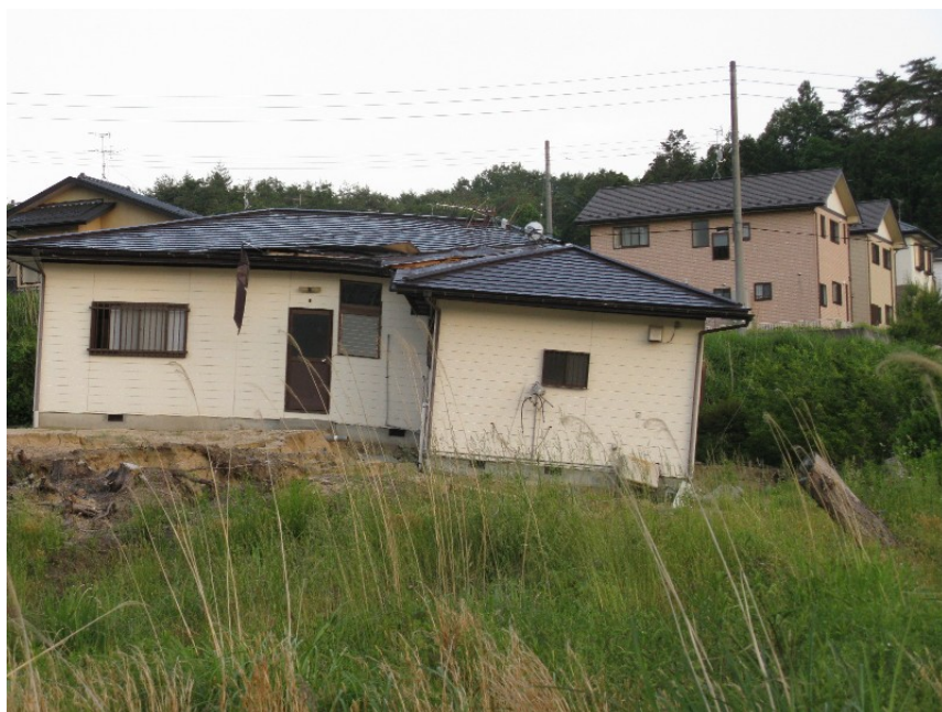
宅地の斜め方向への滑動（白石市郡山字虎子沢山）
