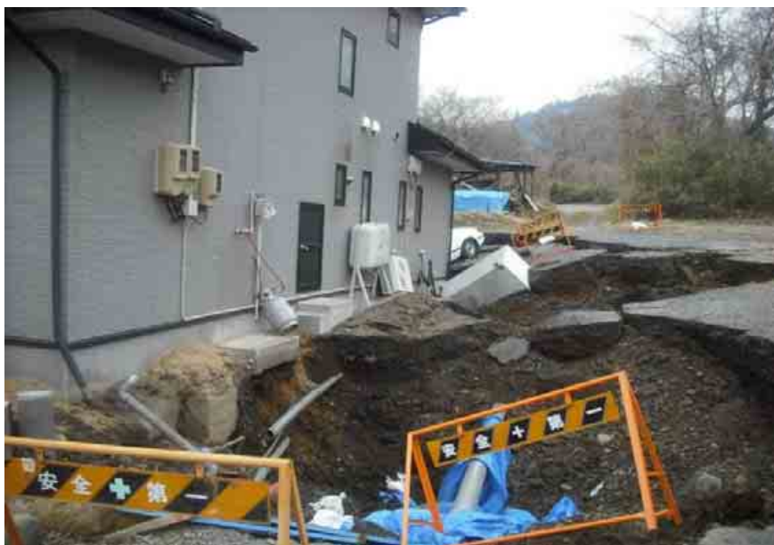
貝塚採掘に起因する宅地の陥没（萩荘字境ノ神地区）
