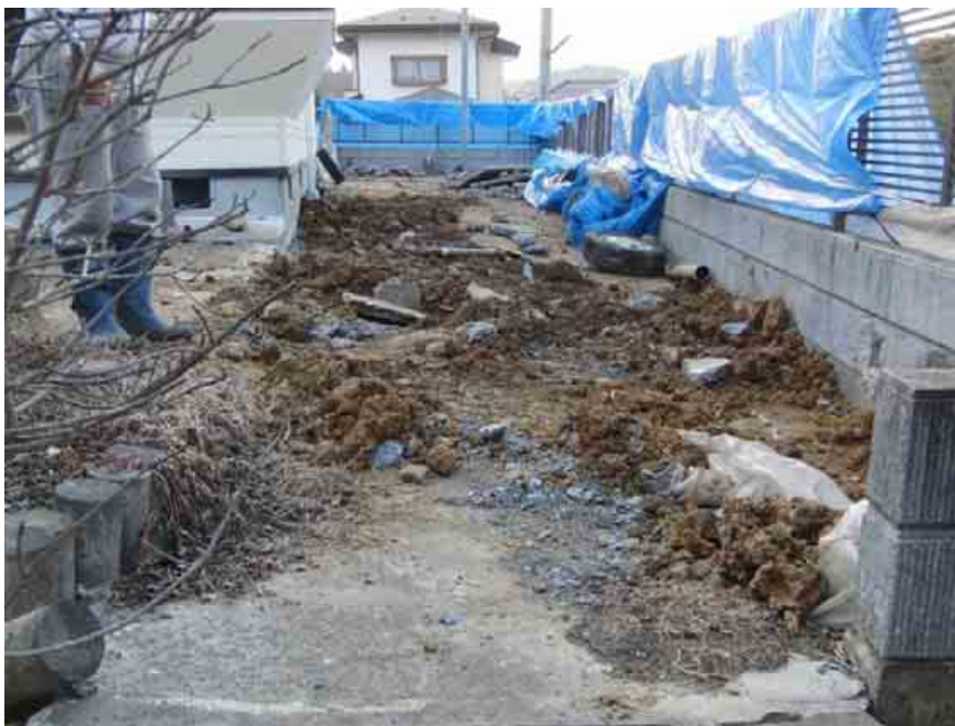
宅地の崩壊（金成有壁地区）
