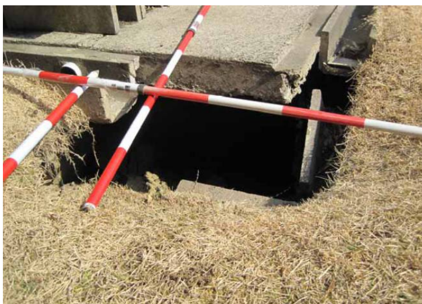
亜炭採掘に起因する宅地の陥没（花泉町金沢字日向地区）
