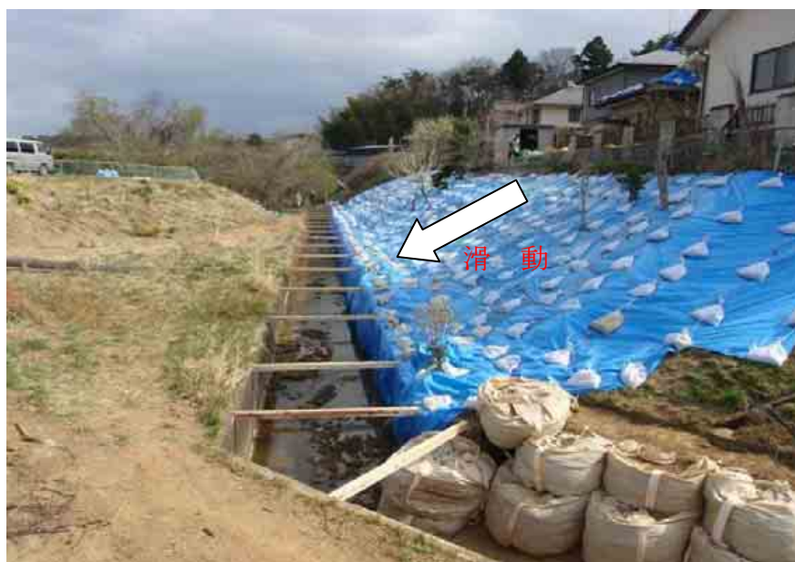
河川側方向への滑動（応急対応）（あさか台団地）
