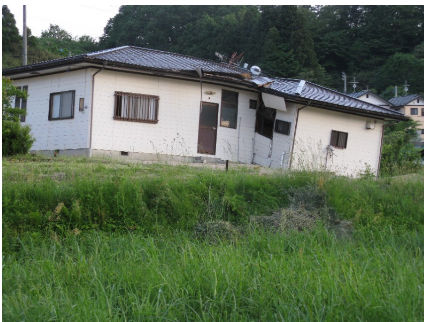
宅地の斜め方向への滑動（白石市郡山字虎子沢山）
