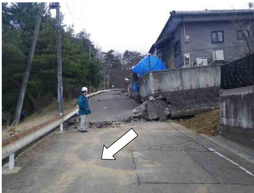
宅地の斜め方向の滑動（青葉区折立地区）
