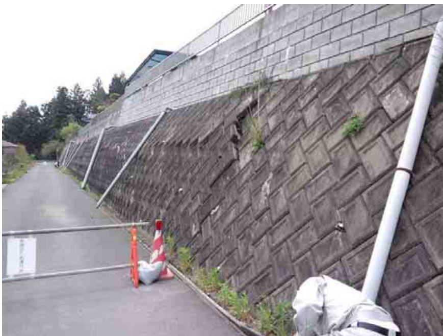
連坦する宅地擁壁の崩壊（花泉町涌津字二ツ壇地区）
