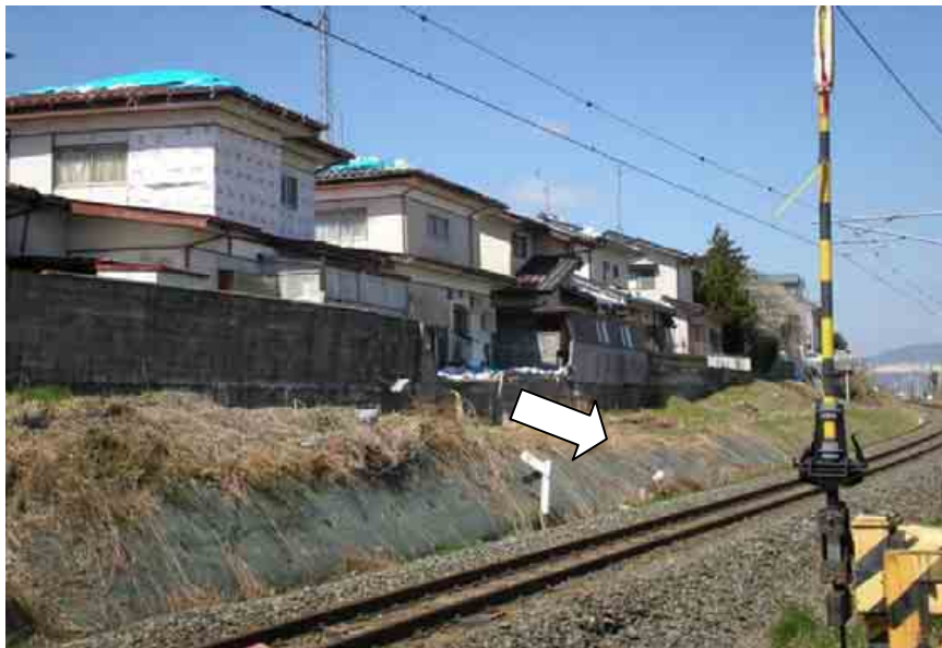
擁壁が斜め方向へ転倒・亀裂（富田町字音路地区）
