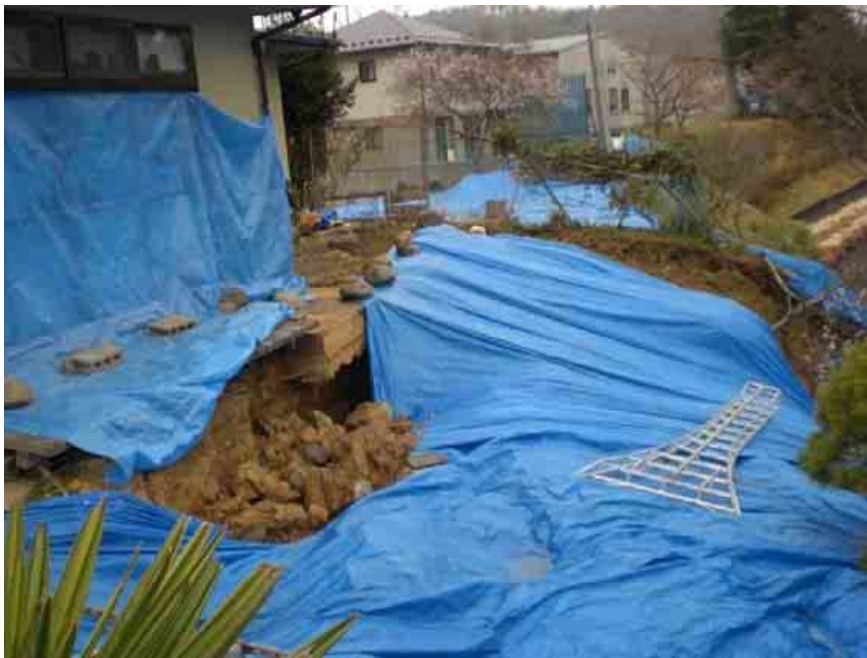
法面と宅地の崩壊（山目字館地区）
